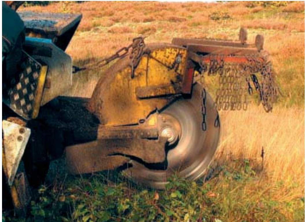
Abbildung 8: Die Stubbenfräse schreddert auch stärkste Eichen- stümpfe bis tief in den Boden. Sorg- wohlder Binnendü- nen am 19.10.04
