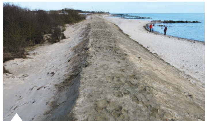
Der neue, sauber profilierte Deich steht genau anstelle zuvor vorhandener Dünen im FFH-Gebiet (März 2024).
